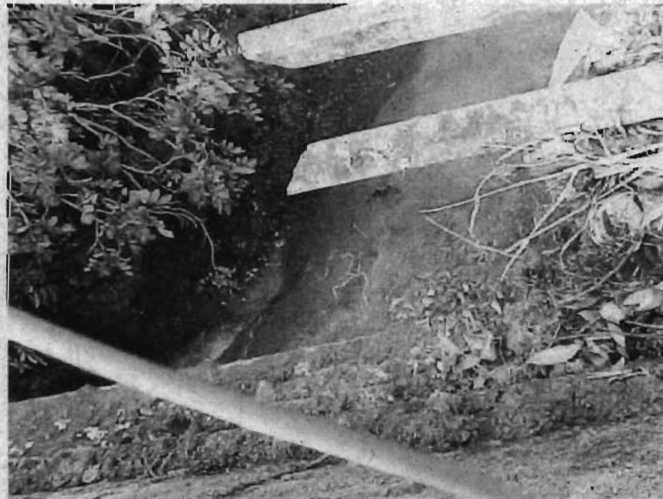
Foto4: Ao centro junto á grade o talude que sofreu ruptura
