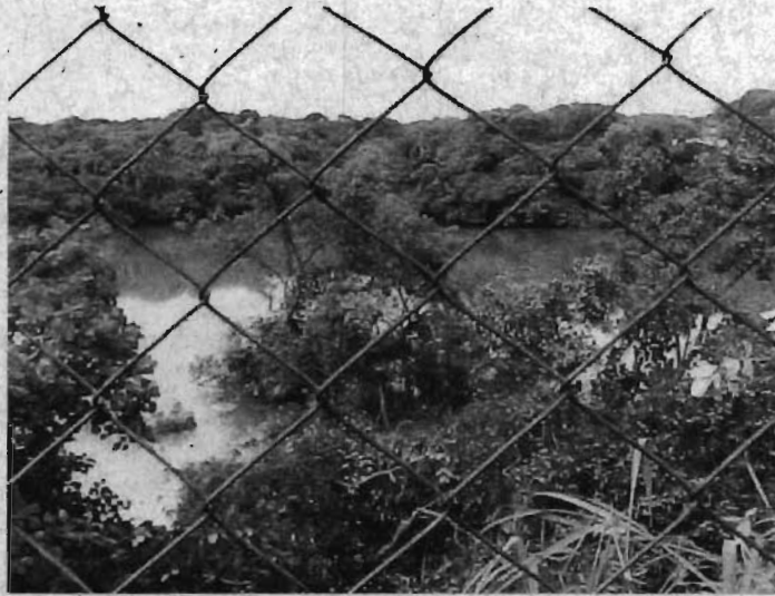
Foto3: Árvores nas águas do lago e que foram deslocadas após o rompimento do talude localizado acima.
