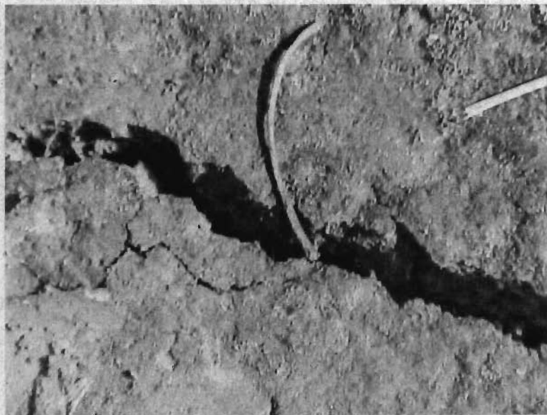
Foto 6: Detalhe de trinca de tração na calçada junto à Av. Miguel Stéfano, no local onde houve a ruptura do talude
